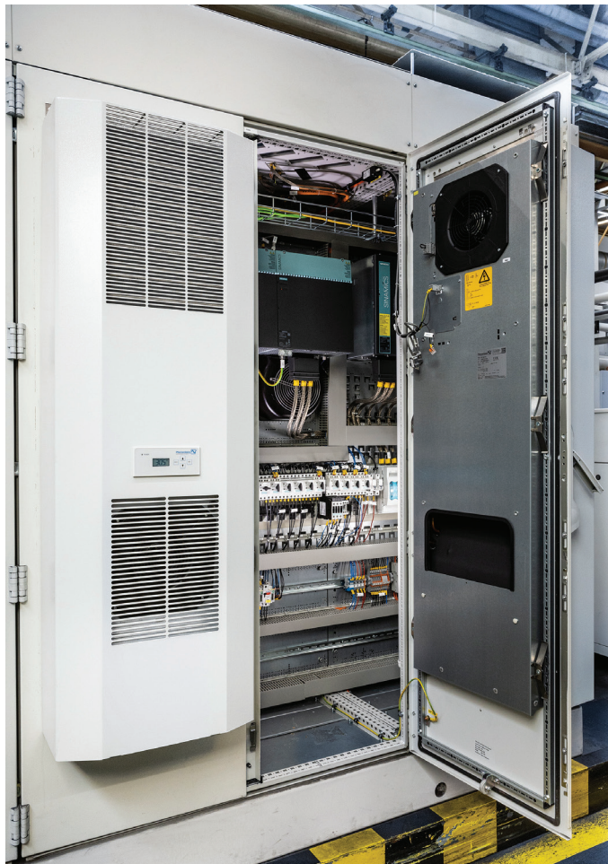
Bild oben: Geöffneter Schaltschrank mit zwei in die Türen teilversenkten X-Series Kühlgeräten DTI 6X1E.
