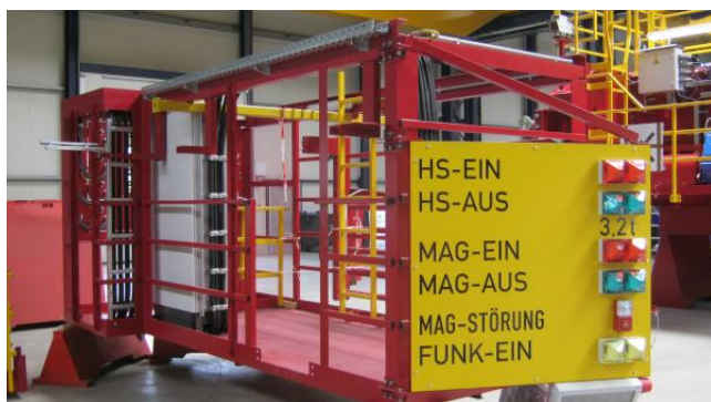
Bild 2: Anzeigetafel für Kranstati in der Werkshalle bei BANG: Die Auswahl verschiedener Signalmodi in Kombination mit zahlreichen möglichen Haubenfarben ermöglicht eine klare Unterscheidung der zahlreichen Kranzustände.
