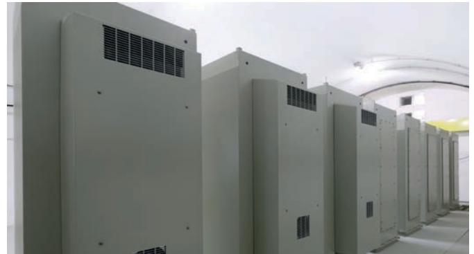
Abb. 2 Querschlag Lötschberg Tunnel mit Schaltschränken und Klimageräten
