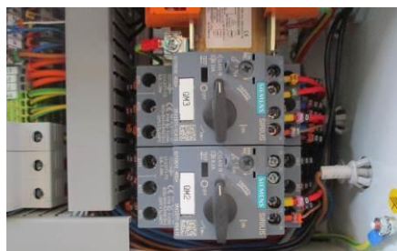
Figura 8 – Interruttori di circuito OFF
