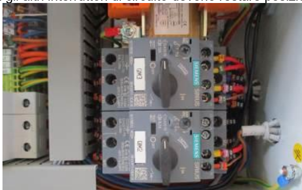
Figura 12 – Interruttore della pompa su ON
