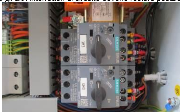
Figura 12 – Interruttore della pompa su ON
