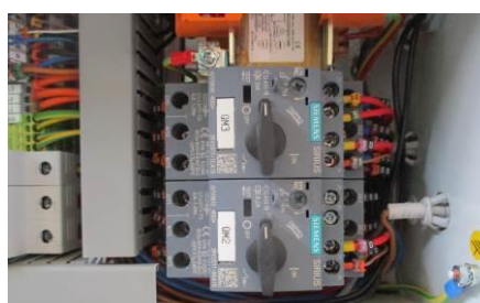
Figura 8 – Interruttori di circuito OFF
