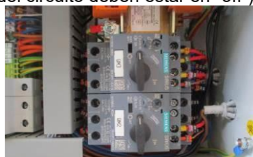
Figura 12 – Interruptor de la bomba en ON
