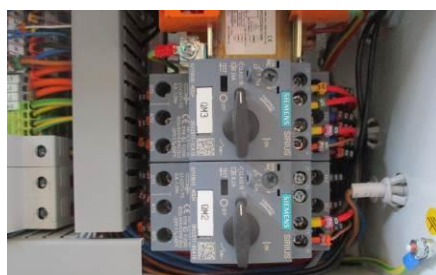
Figura 8 – Interruptores del circuito OFF
