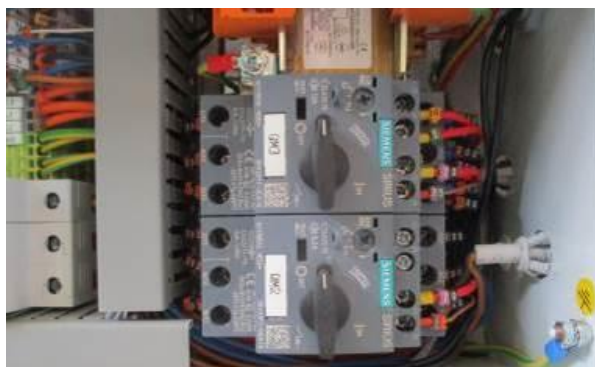
Figure 12 – Interrupteur de la pompe sur ON
